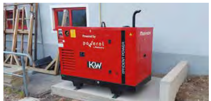
Der neue Stromerzeuger an seinem Stammpplatz.
