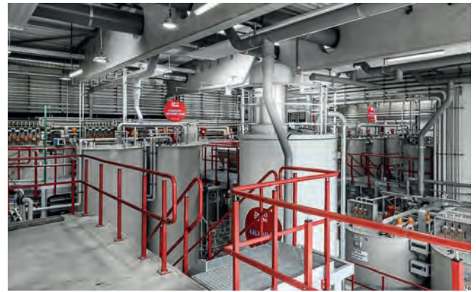
Chemisch-Physikalische Aufbereitungsanlage innen.
