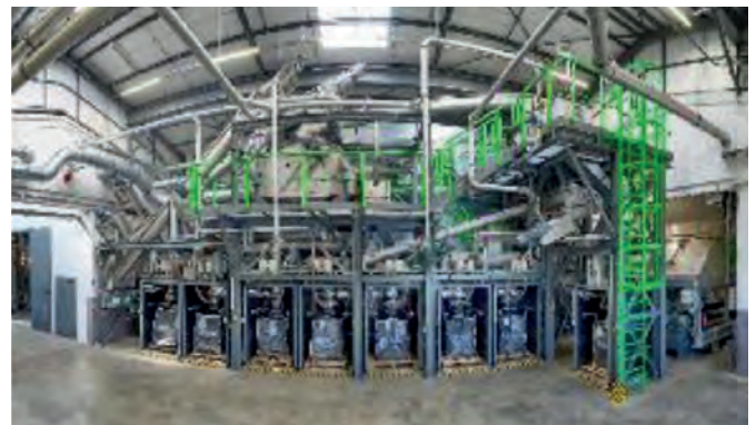
Recyclinganlage für sämtliche Lithium-Ionen-Batterien in Bremerhaven.
